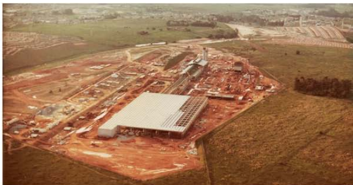
Canteiro de obras do primeiro forno da Cebrace, construído na cidade paulista de Jacareí.
